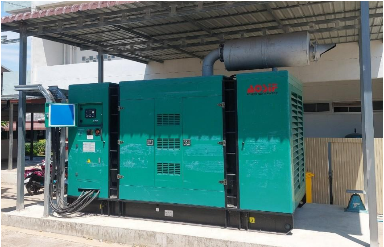
2.เครื่องกำเนิดไฟฟ้าสำรอง ขนาด 500 KW
