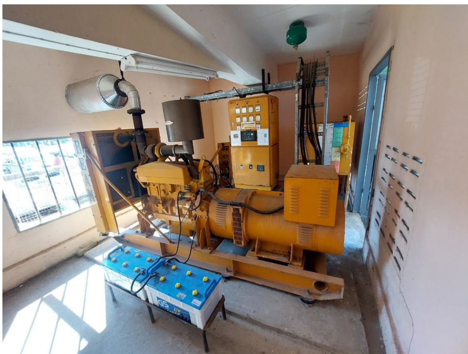
3.เครื่องกำเนิดไฟฟ้าสำรอง ขนาด 100 KW
